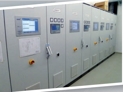
Schaltanlage für Blockheizkraftwerk
