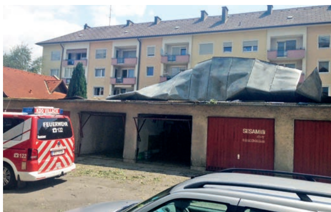
Ein losgerissenes Blechdach in einer Wohnanlage.
