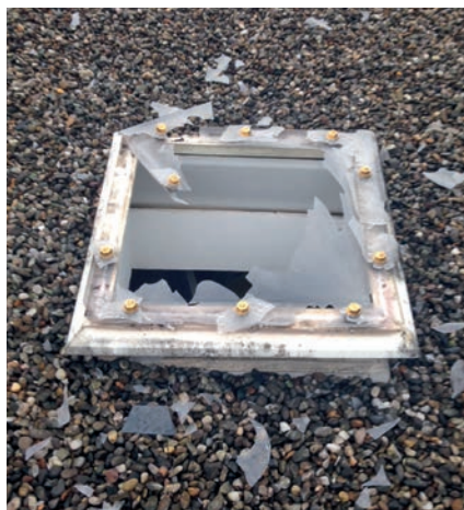
Unzählige Lichtkuppeln wurden durch den Hagel zerschlagen.
